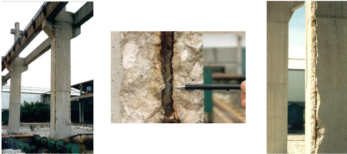
Figura 56 – Deterioração dos pilares
