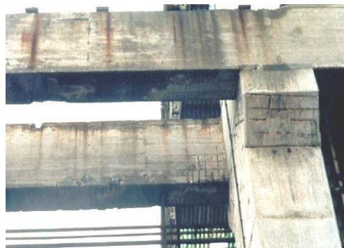
Figura 57 – Armaduras com recobrimento reduzido
