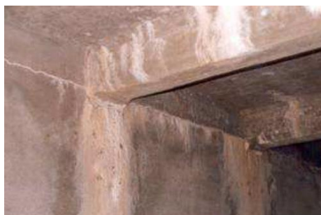
Figura 7 – Eflorescências causadas pelo ataque das águas puras [6]
