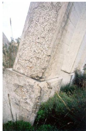
Figura 13 – Deterioração do betão pela acção do fogo [6]
