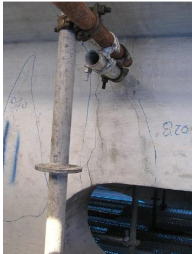
Figura 25 – Identificação e marcação das fendas a reparar [26]
