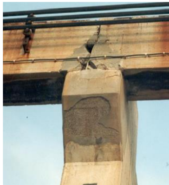
Figura 54 – Deterioração das vigas e consolas nas juntas de dilatação
