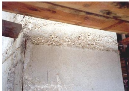
Figura 55 – Segregação dos pilares nas juntas de betonagem, devido à má execução durante a construção
