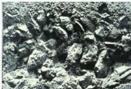
Figura 11 – Deterioração progressiva das camadas superficiais, provocado pela cavitação [6]
